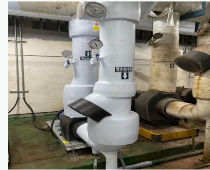
圖 2.2.5、空調冰水泵選用高效率 IE3 變頻泵浦
