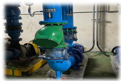
圖 2.2.6、新設冷卻水泵及變頻設備
